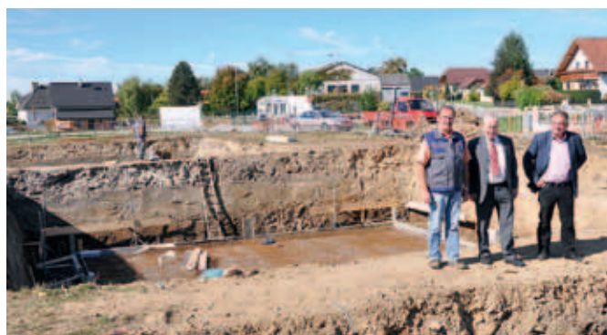
Vom raschen Baufortschritt in der Garser Straße überzeugten sich Bürgermeister Karl Simlinger und Stadtrat Siegfried König bei Polier Josef Gruber von der Firma Mokesch.
