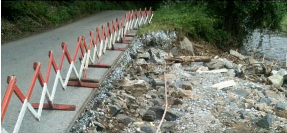
Durch die Flutwelle wurde der Uferbereich des Gemeindegeweges zur Firma Penn weggespült und das Postkabel freigelegt.
